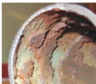
Коррозия в форме ржавчины и трубных отложений
